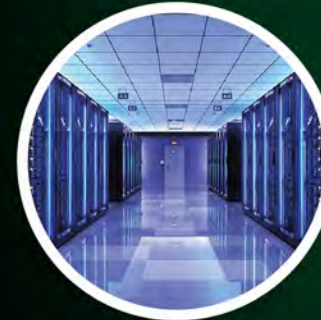
телекоммуникационное оборудование и ЦОД
